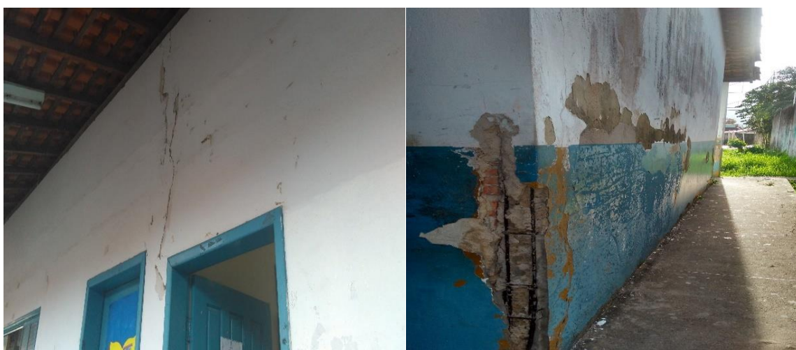
Figura 3 e 4- A estrutura da escola apresenta algumas rachaduras.
